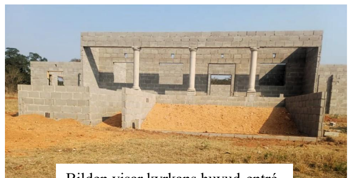
Bilden visar kyrkans huvud-entré. Under arbetsresan kommer vi att gjuta en 6 meter bred trappa samt en handikapp-ramp till vänster
